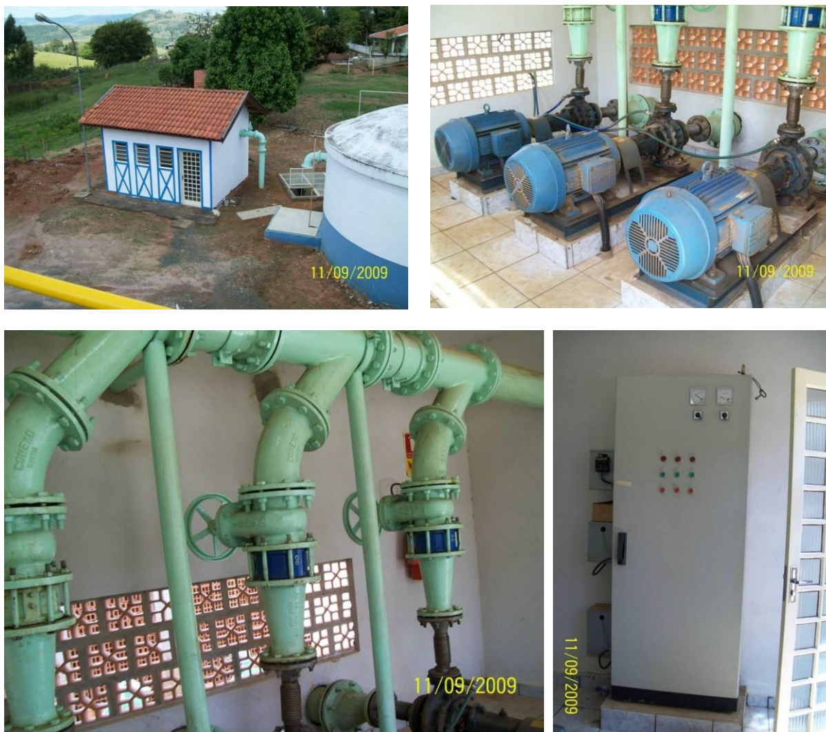
Figura 8.3-M: A partir do canto sup. esq., no sentido horário – estação de recalque; conjuntos moto-bomba; quadro modernizado; tubulação de saída das bombas
