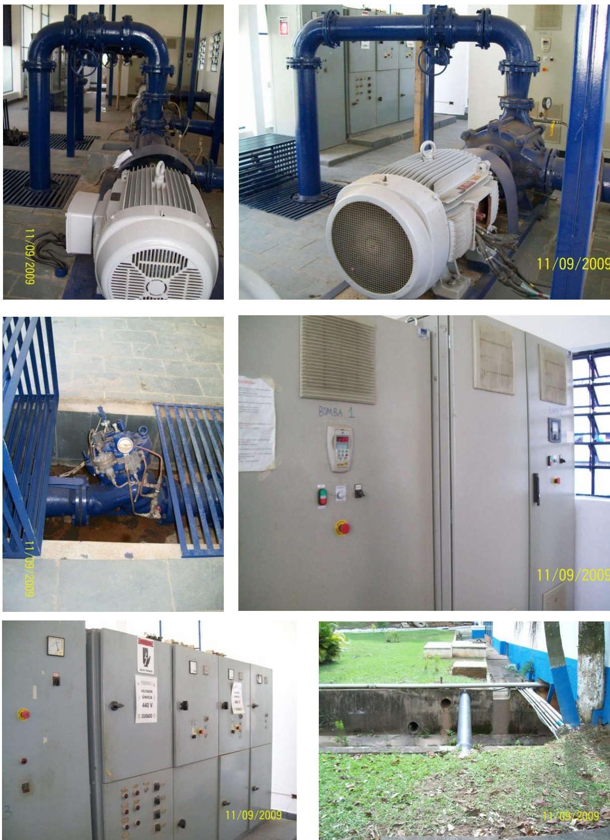
Figura 8.3-H: Aspectos da estação de recalque da ETA, vendo-se embaixo à dir. a saída da adutora de 10”
