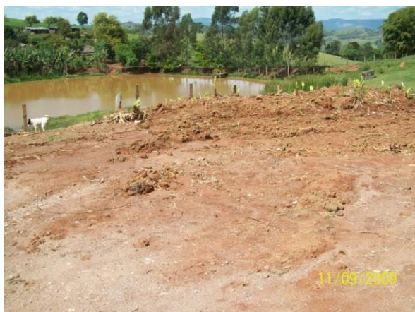
Figura 8.3-N: Área destinada à implantação de leito de secagem de lodo da ETA II
