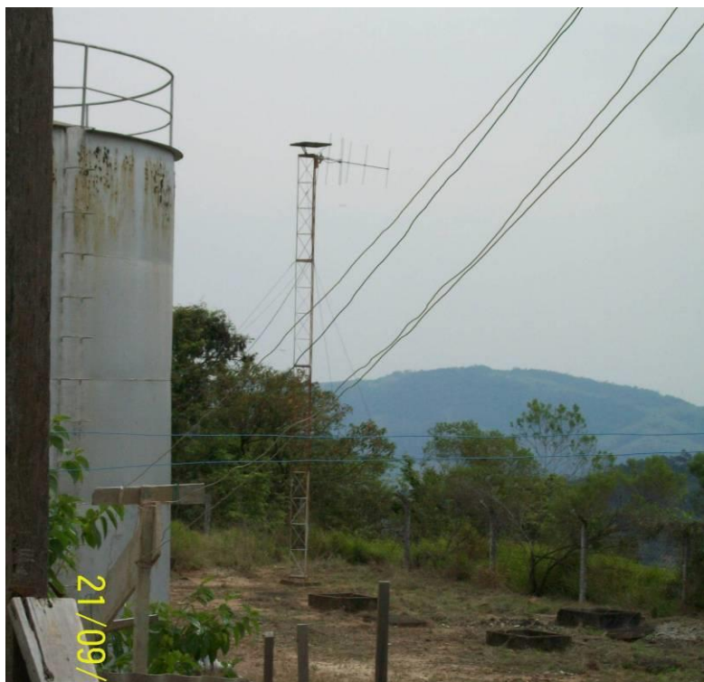
Figura 8.6-A: Antena do sistema de telemetria do reservatório central
