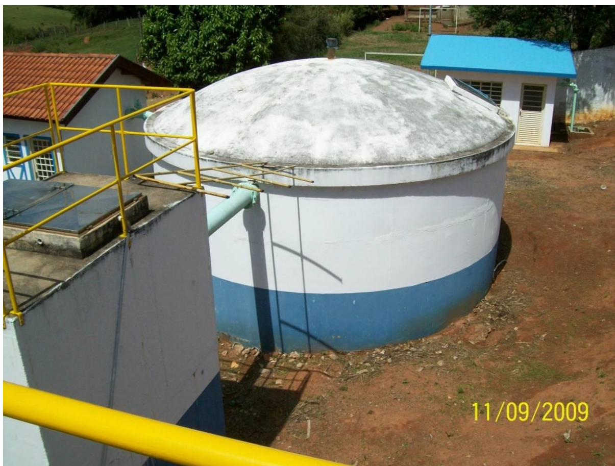
Figura 8.3-L: Em cima à esq. – Tanque de armazenagem de sulfato de alumínio; Em cima à dir. – vista do conjunto de floculadores / decantadores / filtros; em baixo – Reservatório na saída da ETA II
