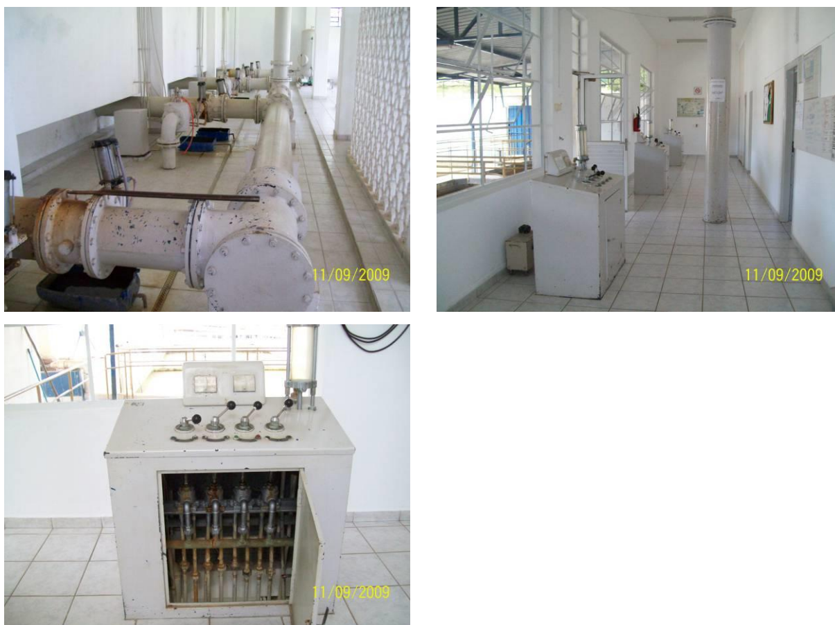
Figura 8.3-D: A partir do canto sup. esq., no sentido horário – saída dos filtros; floculadores; filtros; vista geral da sala de controle; painel de controle
