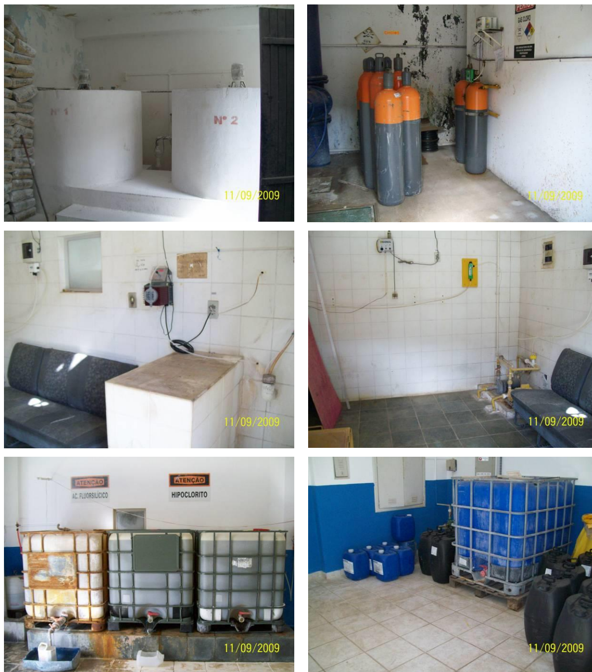
Figura 8.3-E: A partir do canto sup. esq., no sentido horário – tanques dosadores de cal; cilindros e dosadora de cloro; misturador de cloro; armazenagem de produtos químicos; armazenagem de ácido flúorssilícico e hipoclorito, notando-se a ausência de bacia de contenção; dosador de flúor
